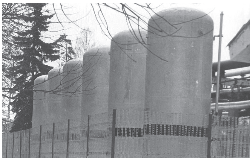
Рессивера для водорода и углекислоты
